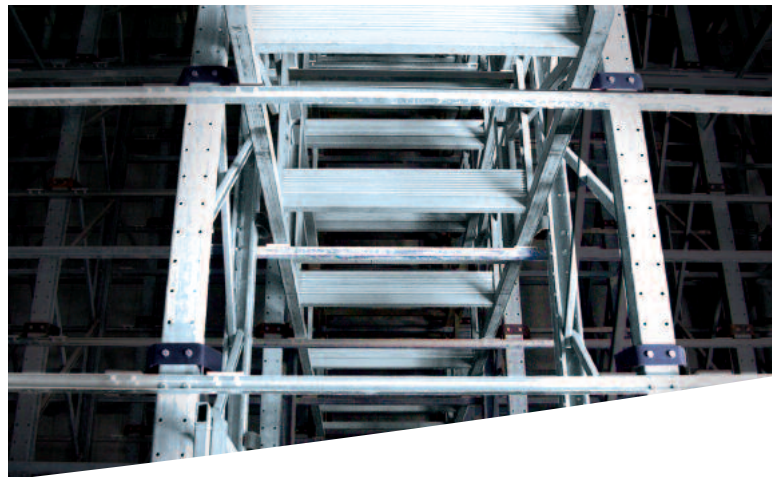
Kundeneigenes Langgutgestell im Wabenlager-Stahlbau.
