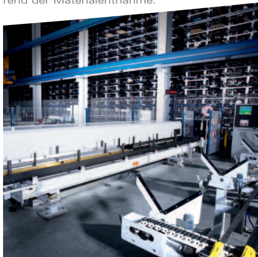
Umlaufstation an der Lagerlängsseite mit Schutzhaube für Kassettenwechsel während der Materialentnahme.
