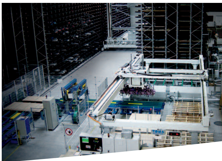
Wabenlager für Langgut/Blech mit vollautomatischer Blechkommissionieranlage.
