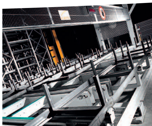
Karussellstation an der Lagerstirnseite.
