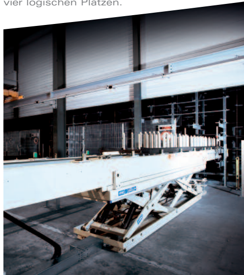
Scherenhubstation lagerlängsseitig mit vier logischen Plätzen.
