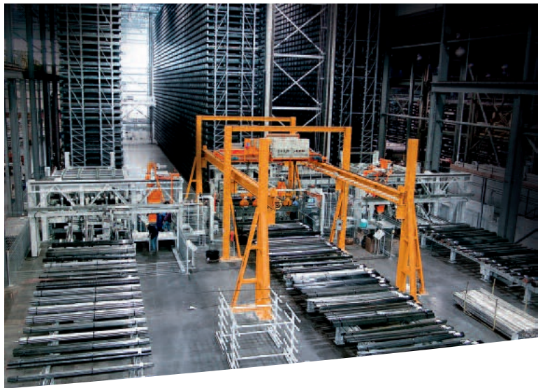
UNICOMPACT mit drei Regalblöcken und zwei Regalbediengeräten.
